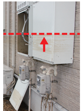
冠水した給湯器
