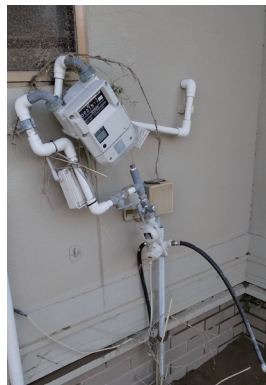
LPガス設備の損傷
